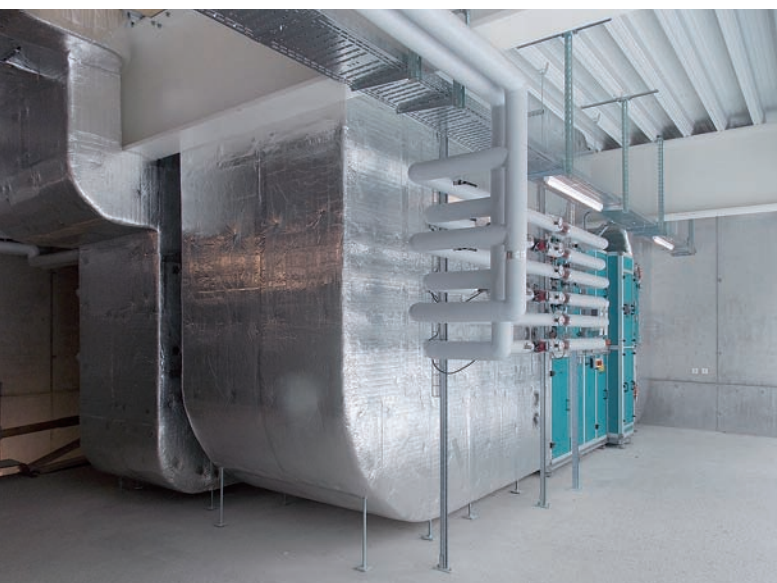
Der Monoblock für die Heizung/Lüftung des Gebäudes ist bereits seit September 2014 in Betrieb.
